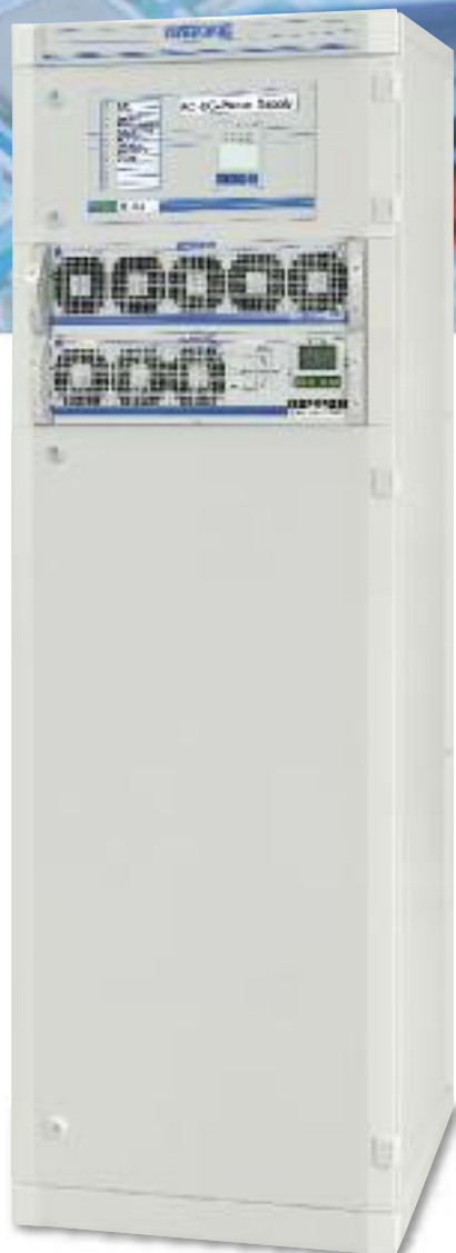
Abb. 8: Gleichrichter-Wechselrichter Systemschrank bestückt mit 3 Wechselrichtermodulen, EUE und Handbypass, Ausgangsleistung 4,5 KVA, sowie 5 Gleichrichtermodulen, Ausgangsspannung 220 V DC, Ausgangsstrom 50 A DC
